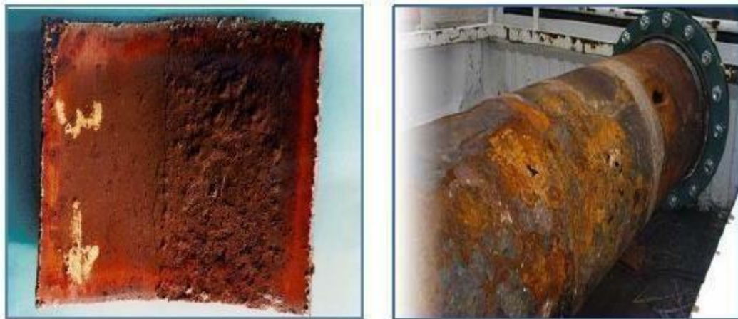
Figure III. 3:corrosion dans le pipe. (a) :internes (b) : externe.[39]
