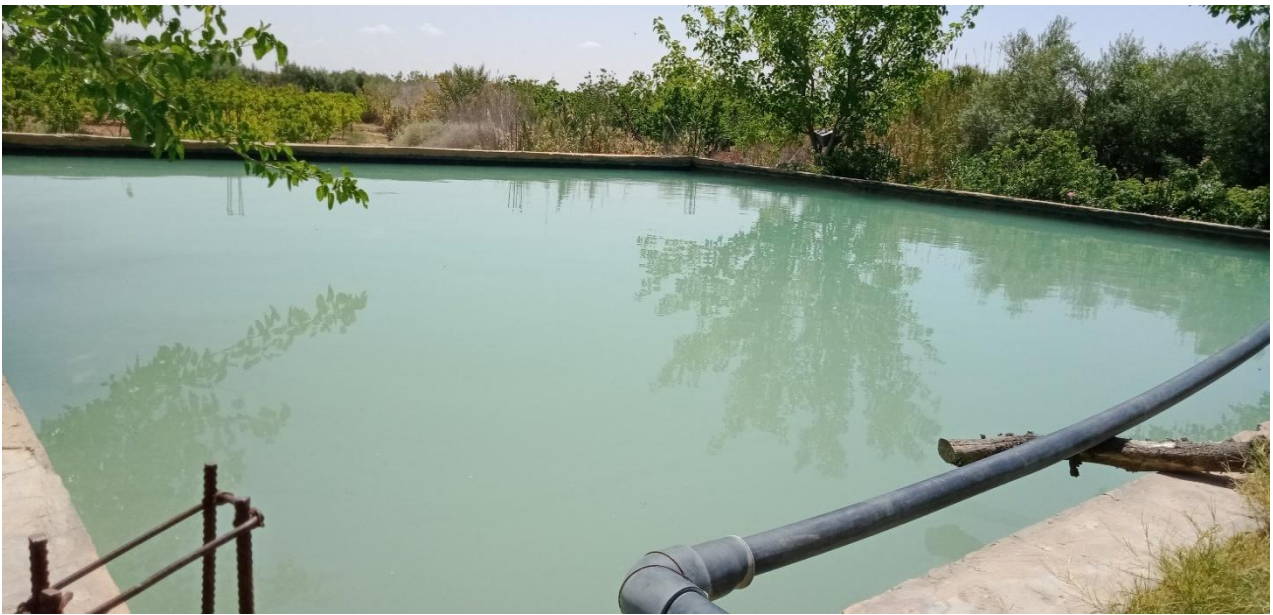
Photo 15 : Bassin bétonné de 5000 m 3 de l'exploitation aquacole de M'Cif
