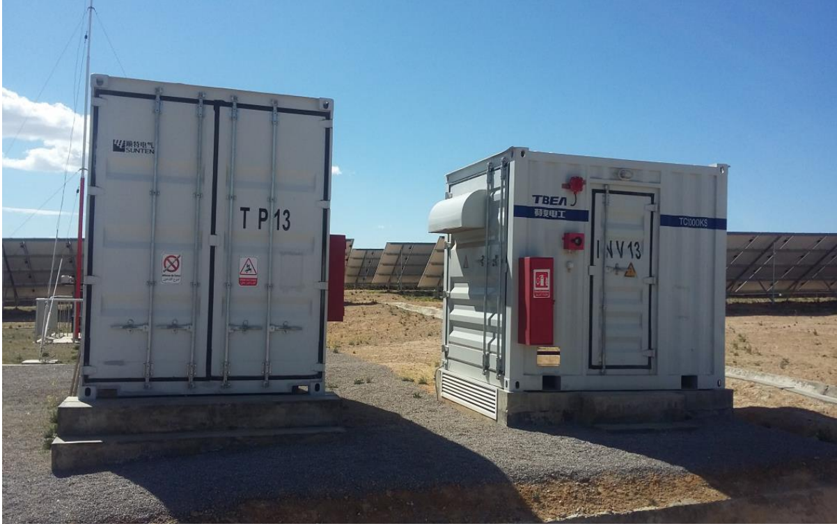
الشكل (9.III). غرفة المحولات
