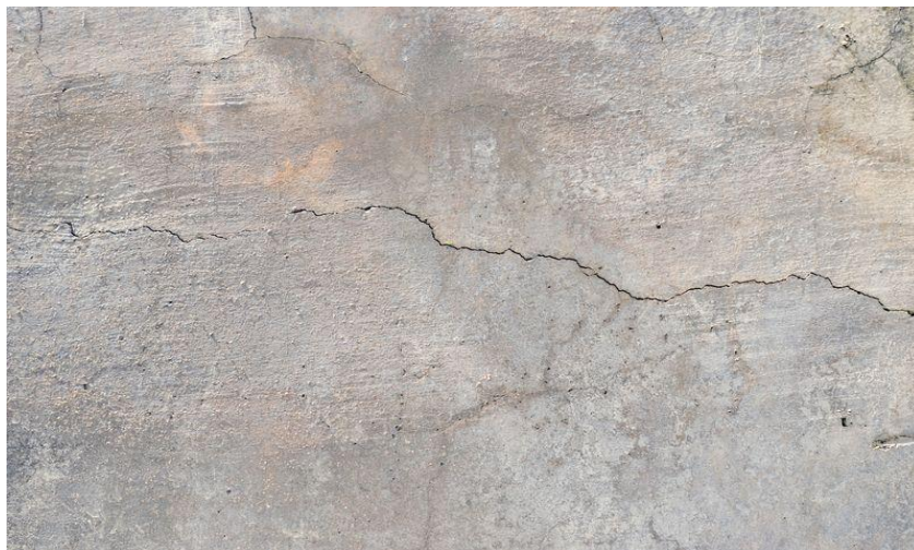
Figure I.1 : fissuration due au retrait du béton (Amina, 11/ 07 / 2019)
