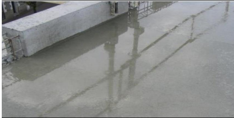
Figure I.2 : Ressuage du béton (Amina, 11/ 07 / 2019)
