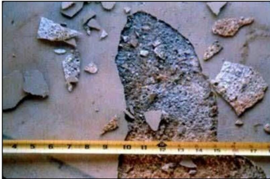
Figure I.4: Délamination d'une dalle (Amina, 11/ 07 / 2019)
