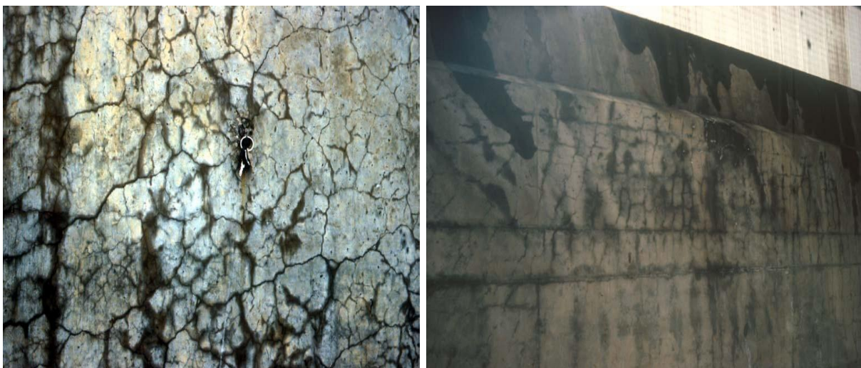
Figure I.9 : Phénomène d'alcali-réaction dans le béton, (M. Dierkens, 19-20 janvier 2011)
