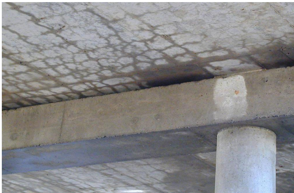
Figure I.10 : Phénomène de réaction sulfatique interne, (M. Dierkens, 19-20 janvier 2011)
