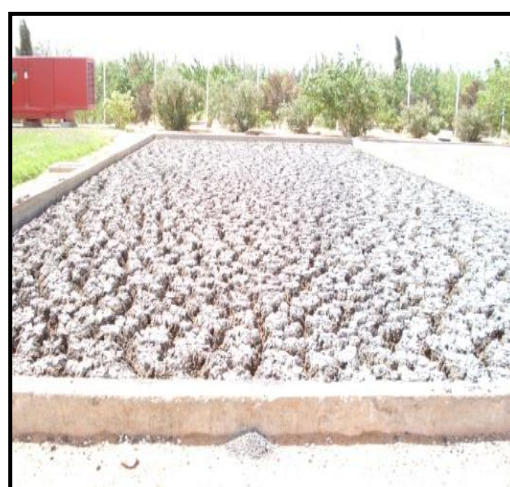
Fig III.13 : Lit de séchage des boues
