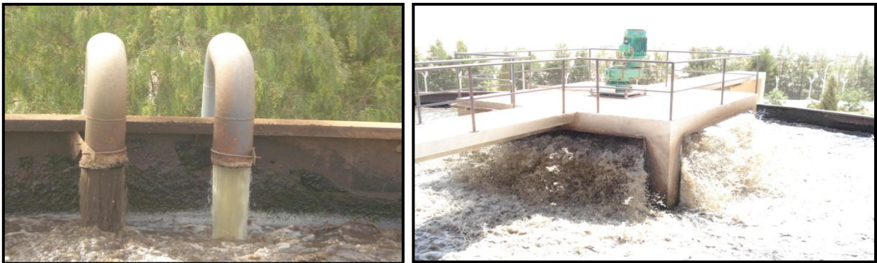
Fig III.8 : Bassin d'aération : à droite aérateur de surface « turbine », à gauche arrivée des eaux usées et de boues activée
