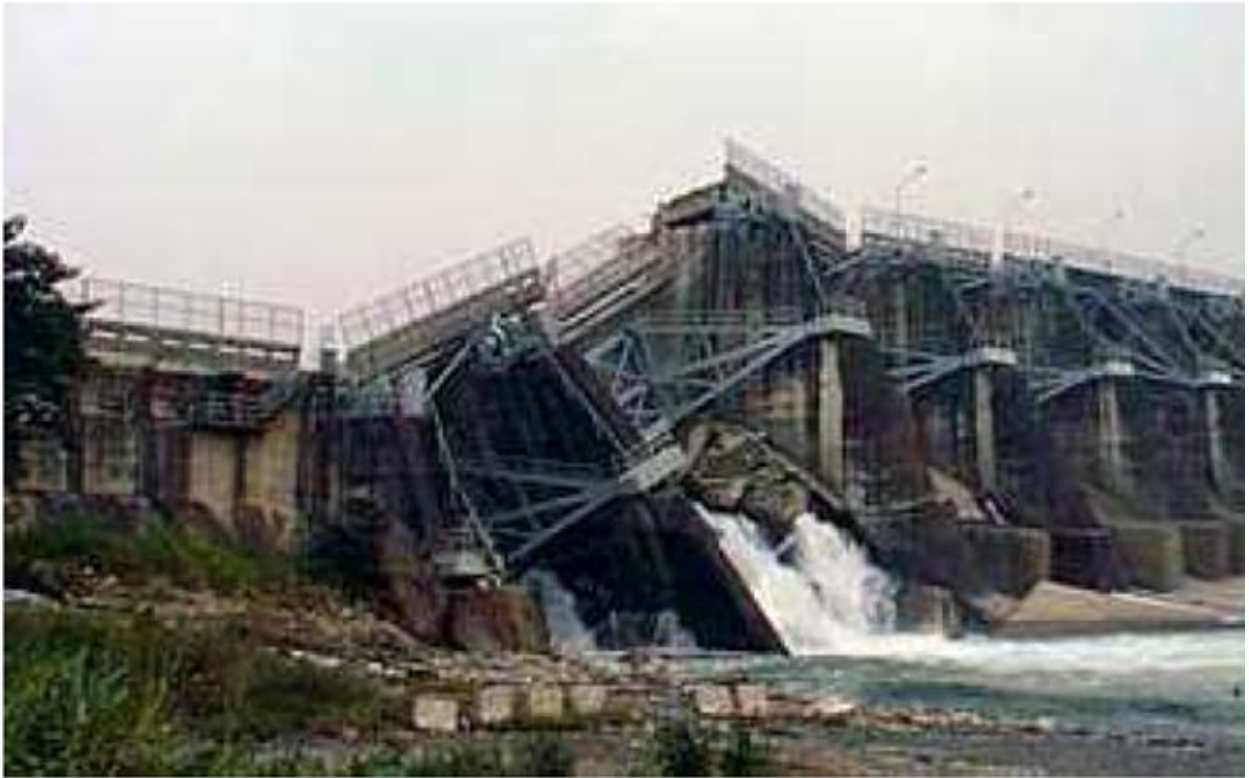
Figure III.7: Barrage de Shih-Kang après le séisme Chi Chi (Taïwan). – rupture au droit de la faille
