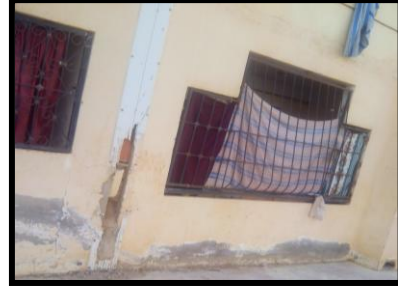
صورة رقم (12): المبنى في حالة متدهورة
