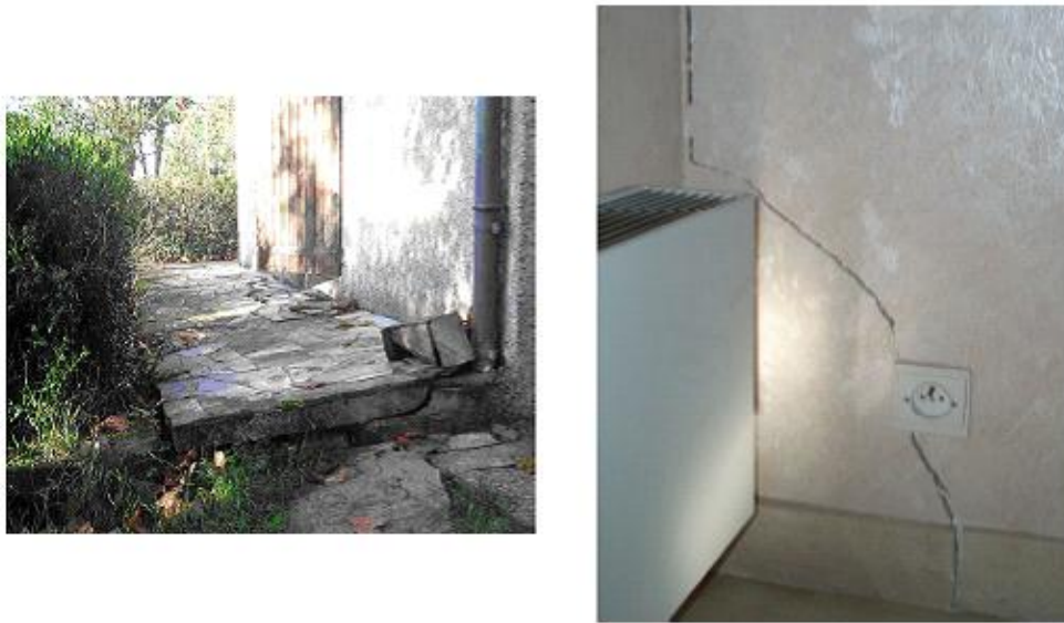
Figure 1.15. Désordres de la structure au cours des périodes de sécheresse (Région bordelaise)
