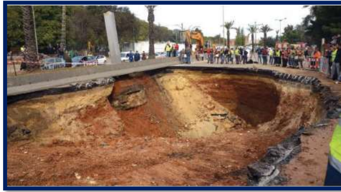
Figure 1.5 : effondrement récent à Alger.
