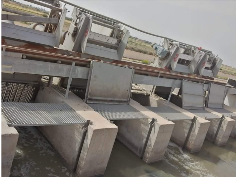
Figure 14 : lamelles de dégrillage (Step m'sila)
