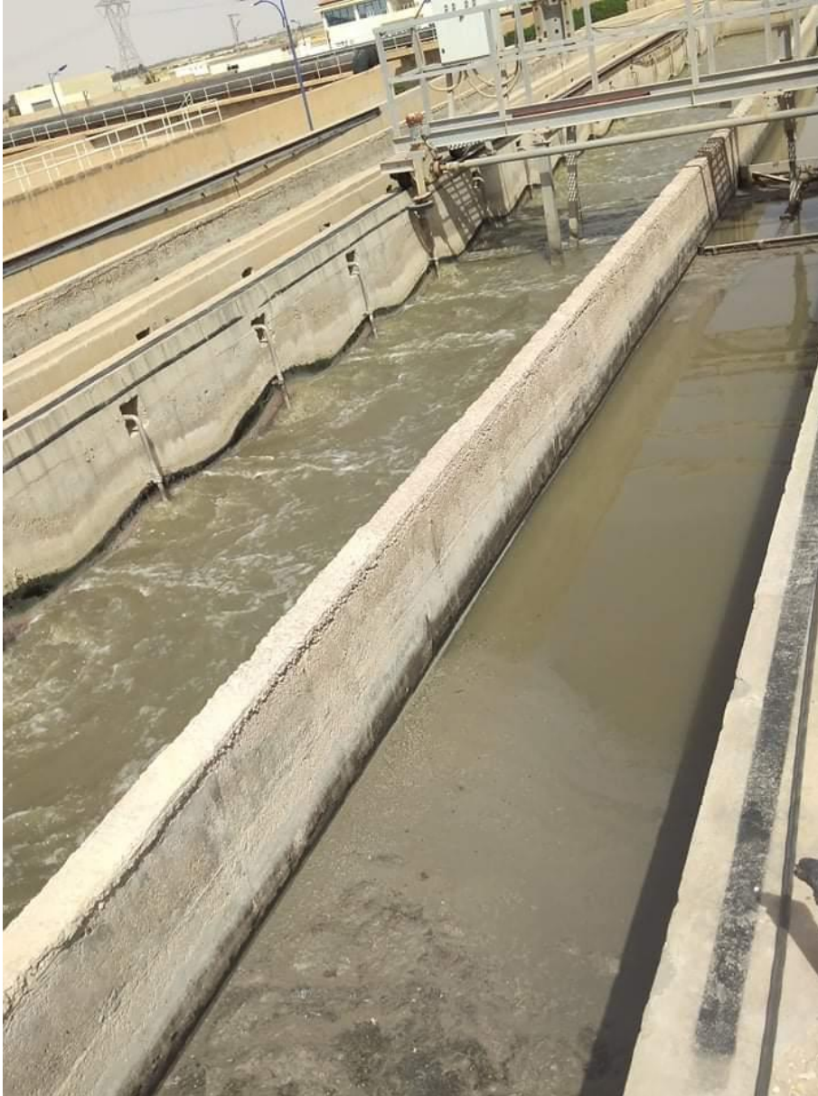
Figure 15 : Désableur-Dégraisseur rectangulaire (Step M'sila)
