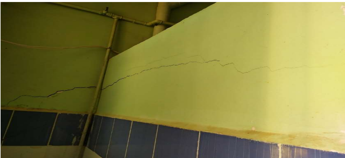
Photos n°16-17-18 : Ouverture du joint de dilatation entre les blocs
