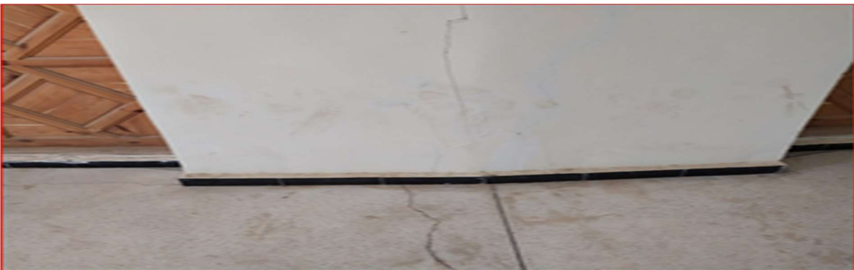
Photos n°13-14-15 : Fissures horizontales au niveau de certains cloisons
