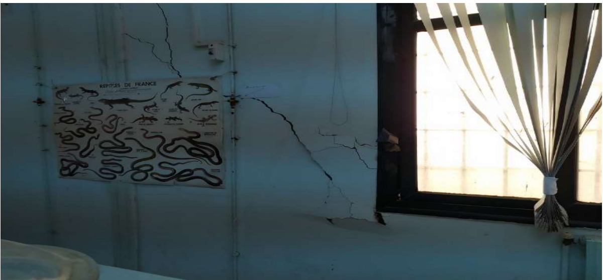
Photos n°19-20 : Ouverture du joint de dilatation entre les blocs
