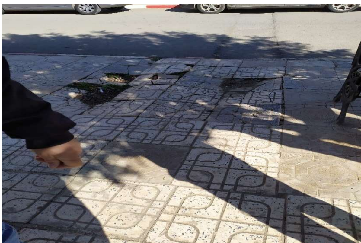
Photos n°21-22 : Fissuration horizontale des cloisons extérieures au niveau de la façade latérale.
