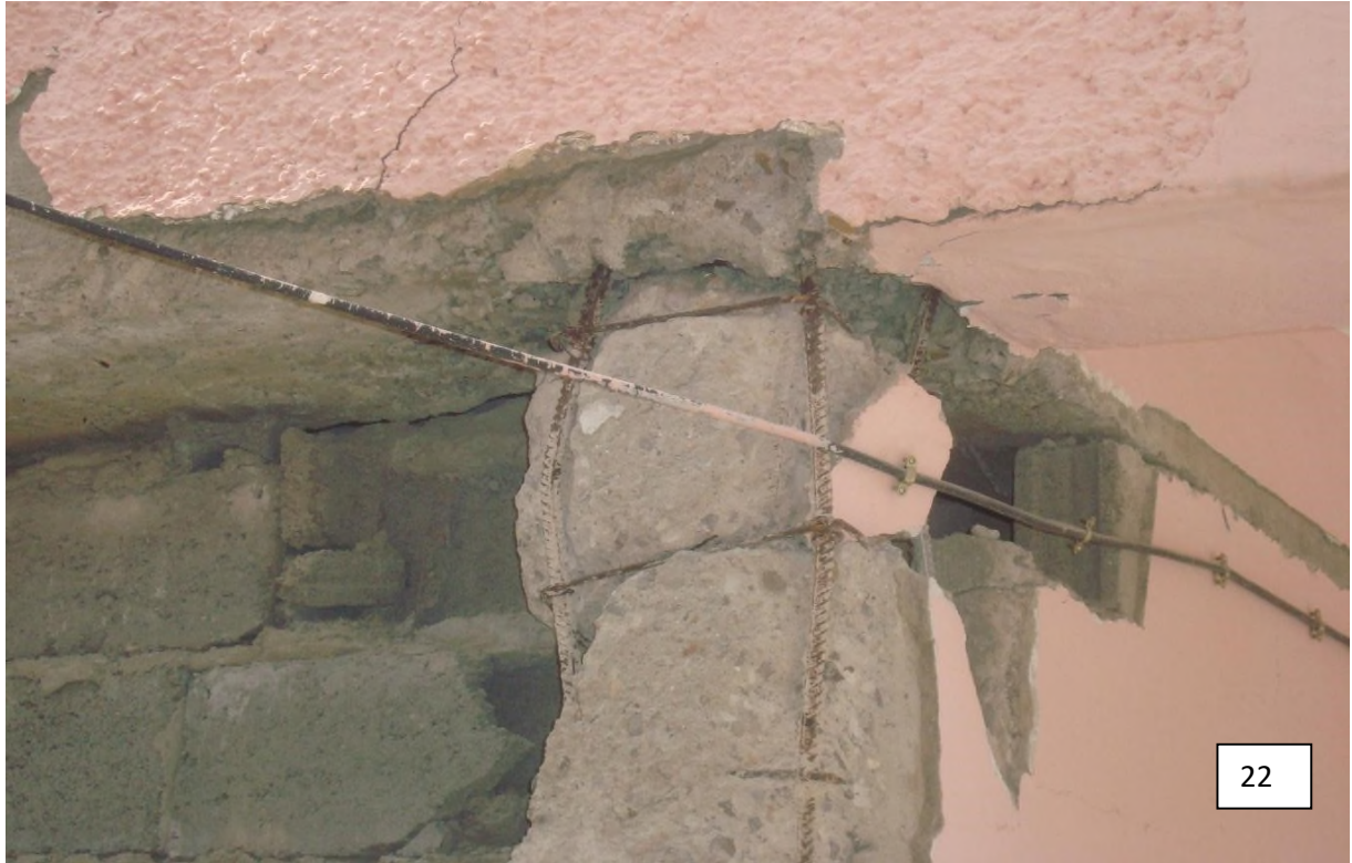
Photos N° 22 Les armatures transversales sont insuffisantes
