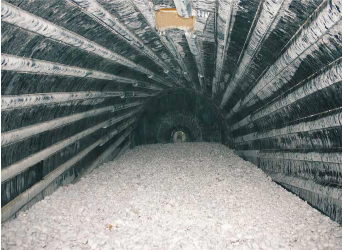
Figure IV.7 : Visite interne de broyeur à boulet avec revêtement en caoutchouc [25].
