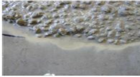
Figure I-13: Laitance en périphérie de la galette d'étalement
