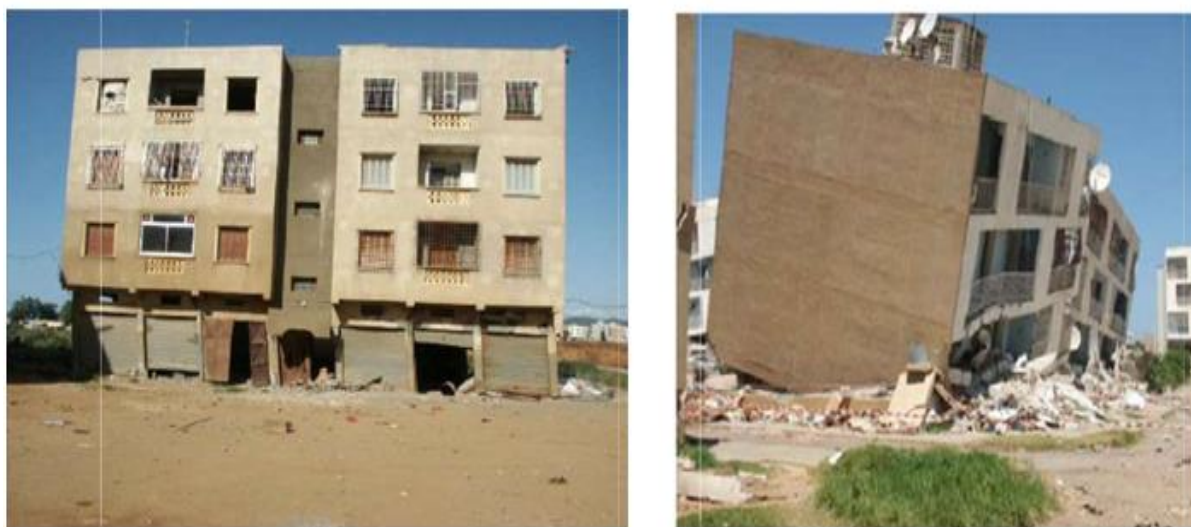
Figure 1.9. Effondrement complet d'un bâtiment en raison du séisme de Boumerdès en 2003.
