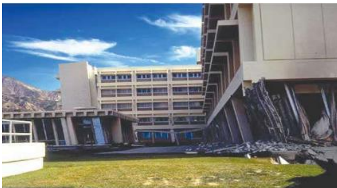
Figure 1.8. Hôpital Olive après le séisme de San Fernando.
