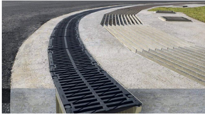
Figure II- 7 réseau de canalisation en béton polymère
