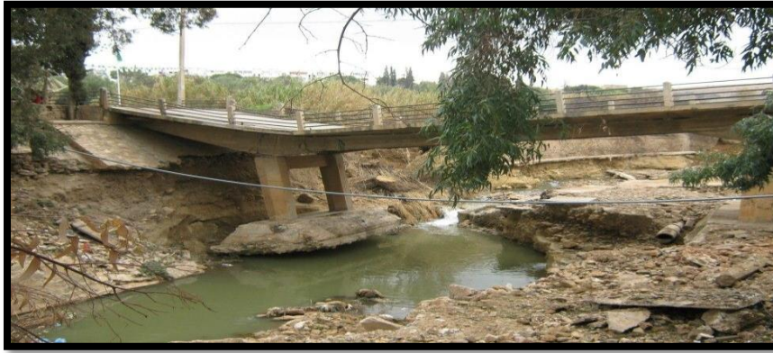
Figure V.6 Destruction des ouvrages (pont du quartier commando Mejdoub wilaya de Saida en (2013)
