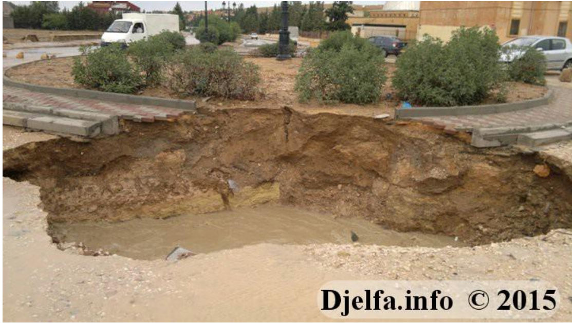
الصورة رقم (2): تبين انهيار الطريق بحي برنادة (شمال الجلفة)
