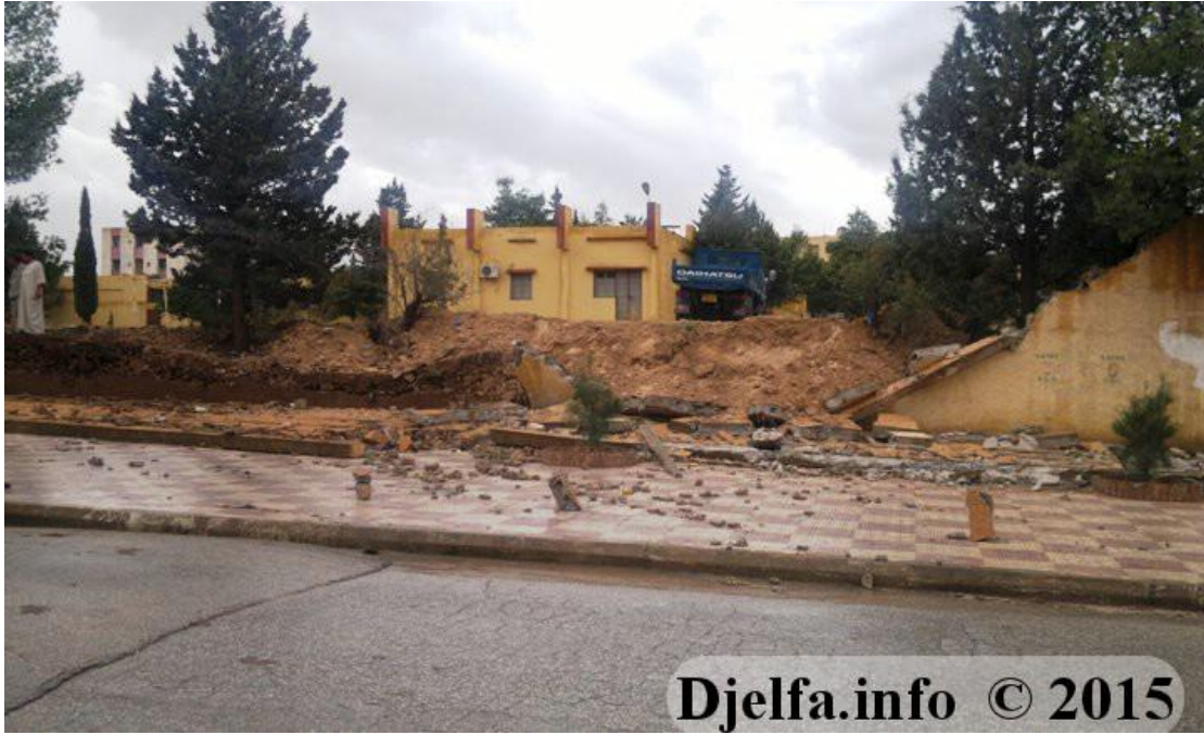
الصور رقم (7): سقوط جزء من جدار مركز التكوين ببربيح (جنوب الجلفة)
