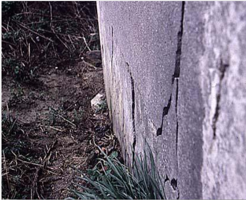
a) Fissuration sévère d'un massif de fondation .
