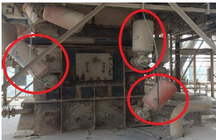
Figure V.10: Disposition des air-chocs au niveau du calcinateur.
