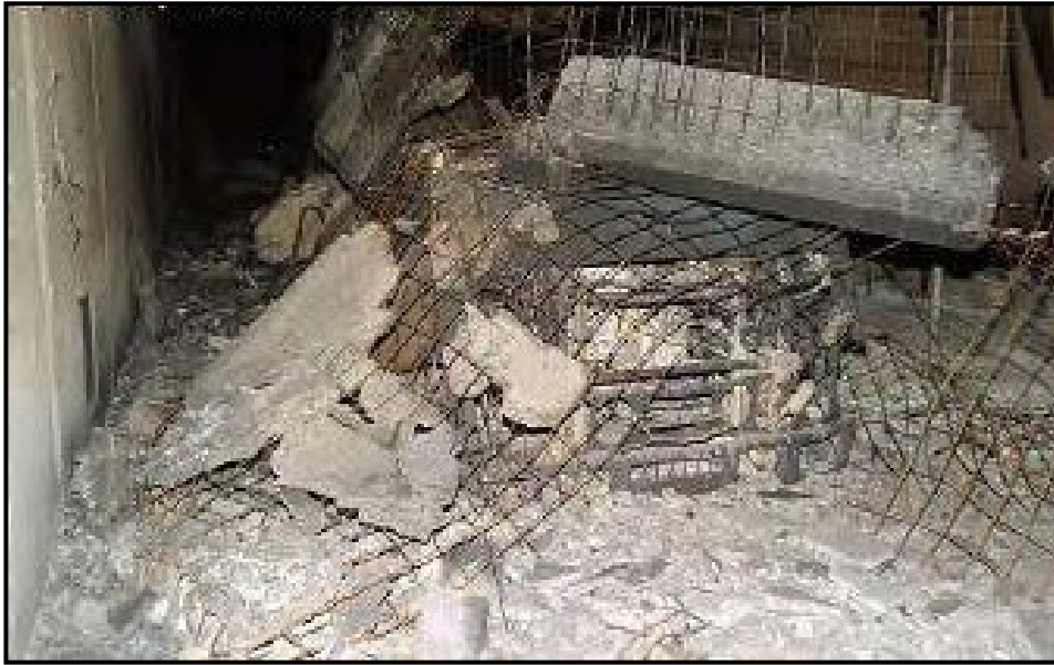
Fig. II. 4 Section effondrée du faux plafond dans le tunnel du Gothard après l'incendie du 21 octobre, 2001 thèse doctorat 2007 Annaba
