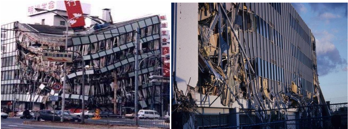
Fig.1.3. Bâtiments en acier effondrés lors d'un tremblement de terre [3].
