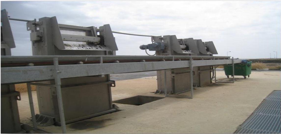
8 Fig. III. 02: Les dégrillages grossiers.
