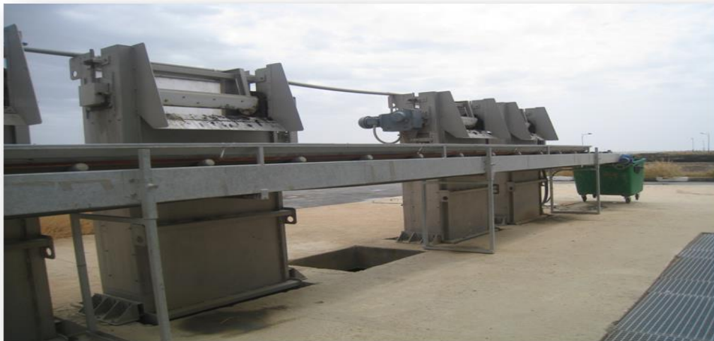
2Figure II . 02 : Dégrilleur grossier
