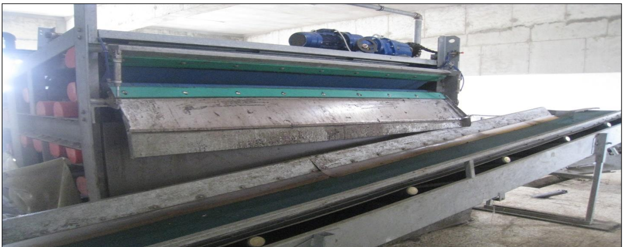
18 Fig. III.12: Les filtres presses à bandes.
