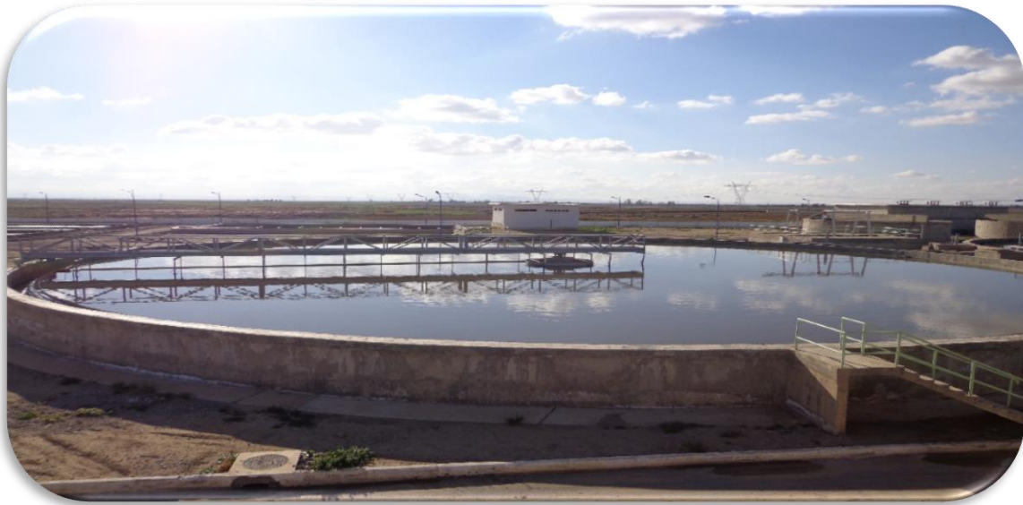
16 Fig. III 10: Décanteur secondaire.
