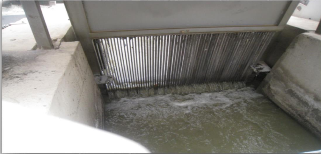
10 Fig. III .04: Les dégrilleurs fins.
