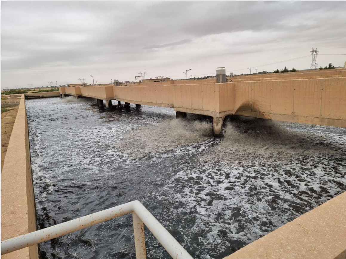
14 Fig. III .08: Le bassin d'aération.
