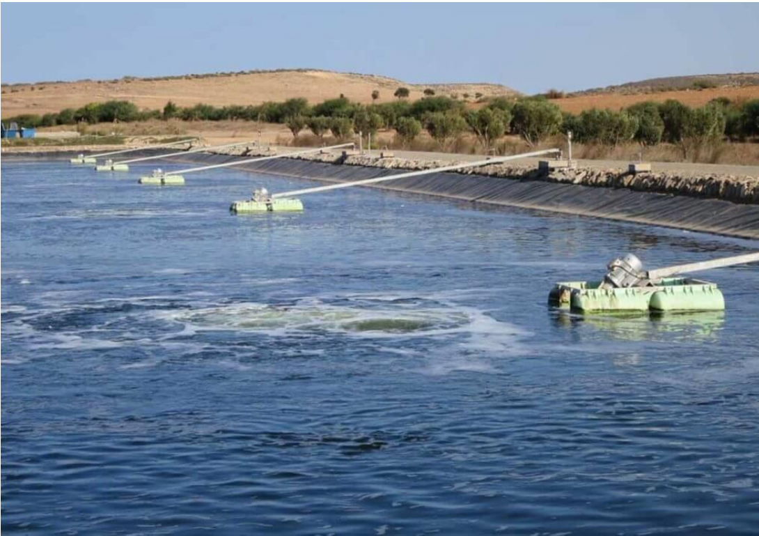
5 Figure II. 05 : Lagunage aéré
