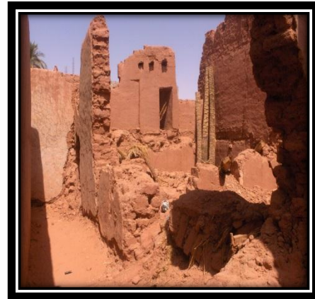
الصورة رقم (41): مساكن منهارة
