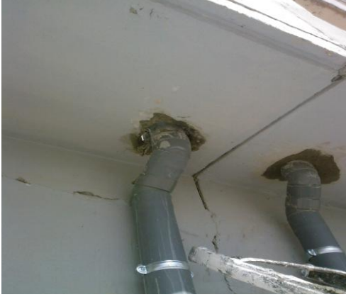
الصورة رقم 94 : أنبوب بي في سي لتصريف مياه الشرفات
