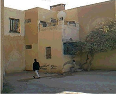
الصورة رقم 81 : الإطار المبني قبل التدخل
