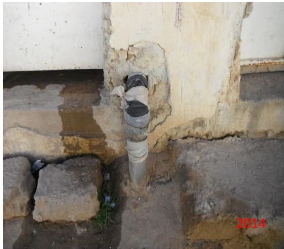
صورة (33.5): حفر الصرف أمام باب المنزل وتدهور حالة أنبوب الصرف
