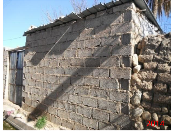
صورة (9.5): بناء في حالة متدهورة
