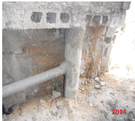
صورة (32.5): قدم وتآكل أنابيب الصرف
