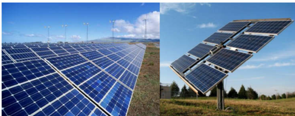
Figure (II .5) : panneau photovoltaïque.
