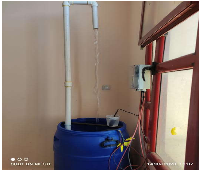
Figure (IV.1). Banc d'essai de caractérisation des systèmes de pompage photovoltaïque
