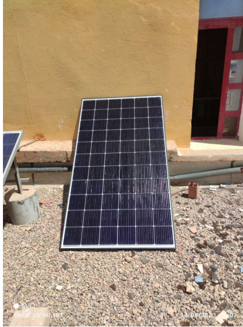
Figure (IV.3) : panneaux solaire de p=400 w
