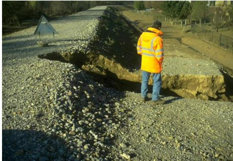
a- Renard le long d'une conduite
