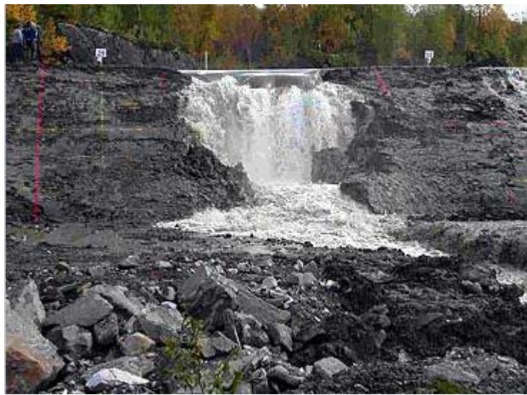
Fig. I.8 Rupture par surverse [8]
