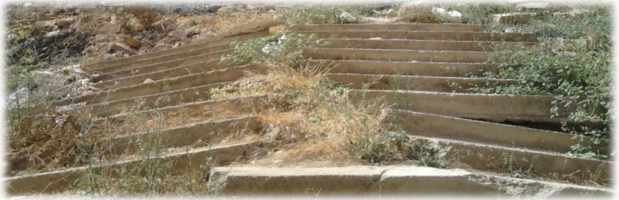
صورة رقم (10): انهيار سلالم جراء هبوط ارضي
