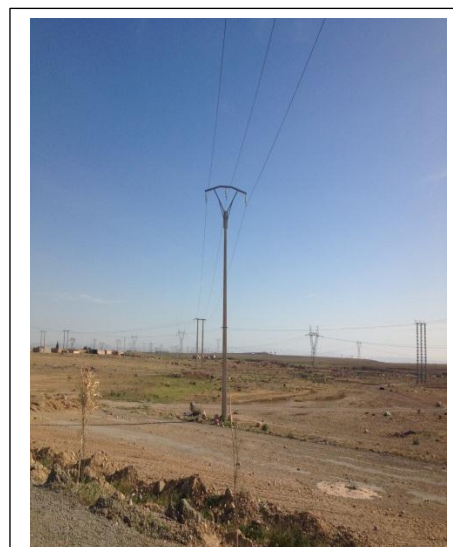
Figure N°41: poteau électrique MT
