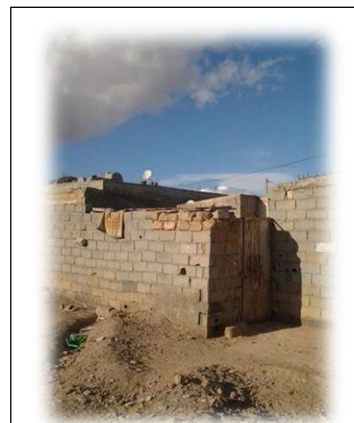
Figure N23: mauvais état
