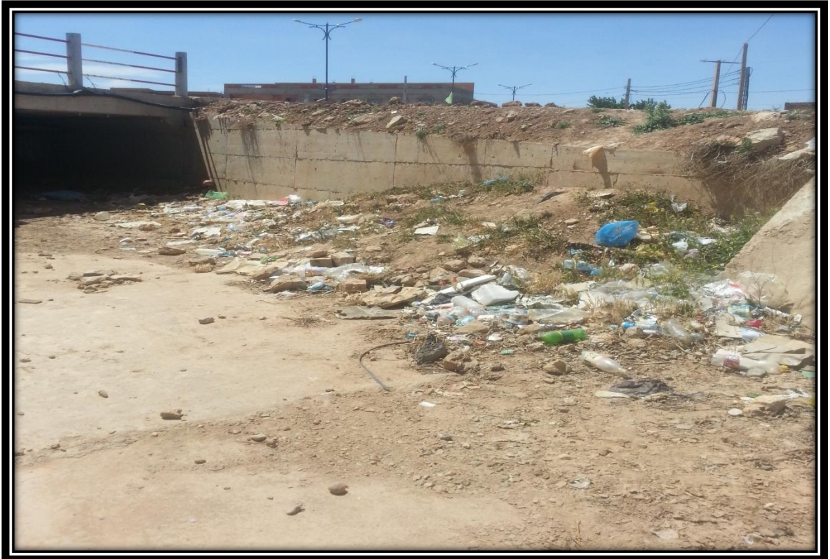
Photos n°10 : Le jet des remblais dans le cours d'eau abouti à des inondations liées aux embâcles (Oued MEDRISSA ; Avril 2017).
