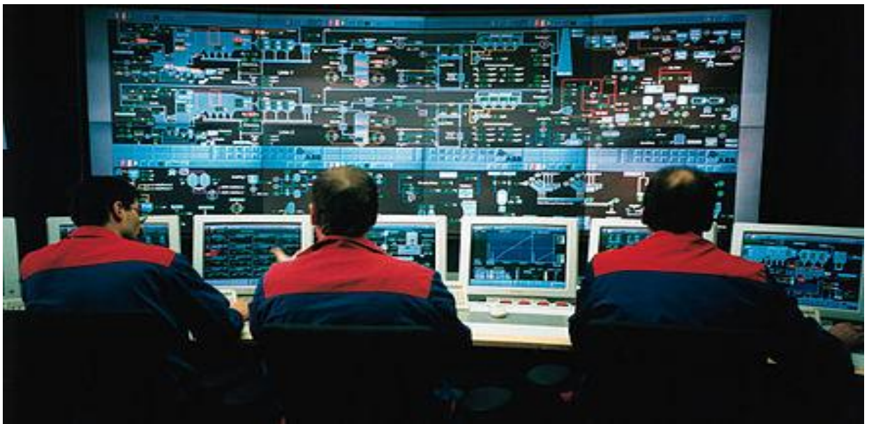
Figure.I.16. Salle de commande d'une centrale électrique.[8]
