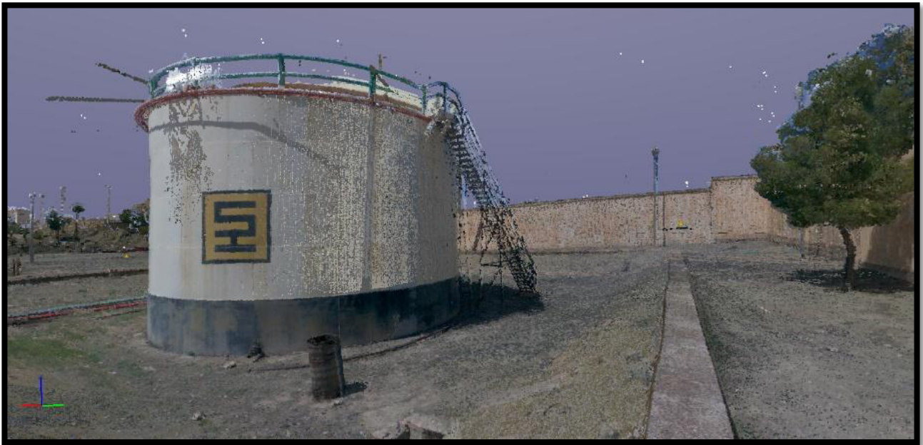
Figure 14: Réservoir de pétrole
