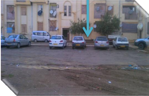
صورة رقم ( 22 ) حالة سيئة للطريق داخل الحي
