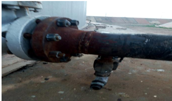
Figure (3.9) : La conduite de décantation.
