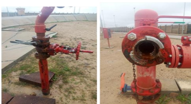
Figure (3.5) : Lance monitor fixe à eau (bac 3A1).
