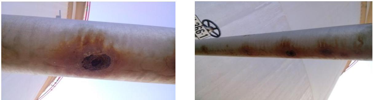
Figure (3.7): Corrosion au niveau de la conduite de décantation bac 3A1.
