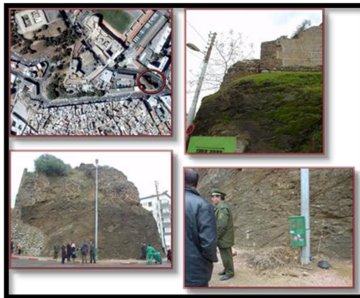
Figure 11: Exemple : l'intersection des boulevards de la victoire et de Taleb Mohamed : Eboulement par effritement de la roche de la muraille cotée boulevard de la victoire
