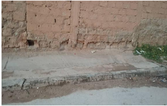
الصورة 05: تدهور الواجهات السفلية للمباني بسبب الرطوبة الصاعدة
