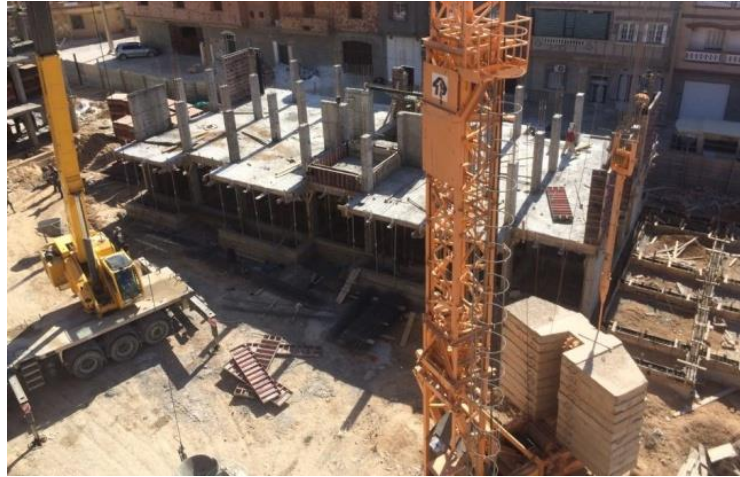
Figure III-8- Chemin de roulement des grues
