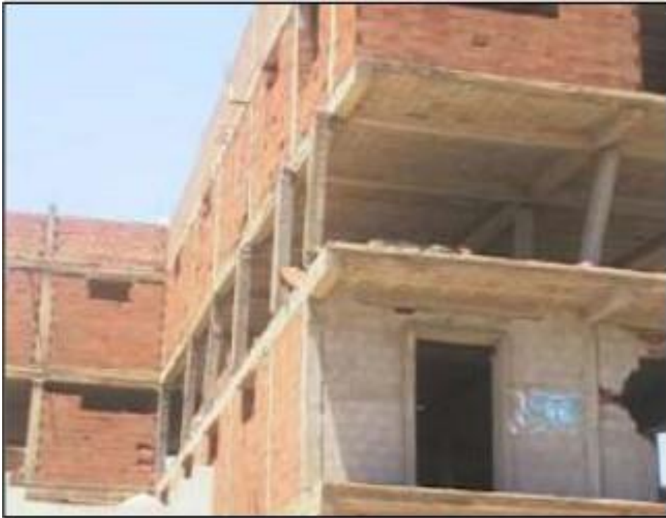
FIGURE 1.9 : Cisaillement des poteaux d'une construction à Bordj el bahri. Séisme de 2003, Boumerdes, Algérie
