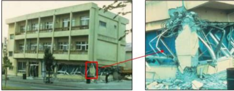
FIGURE 1.14 : Dommages aux poteaux d'angle dus à la torsion induite par l'excentrement des murs de contreventement du rez-de-chaussée (la disposition asymétrique des voiles), séisme de Tokachi-Oki, Japon, 16.5.1968
