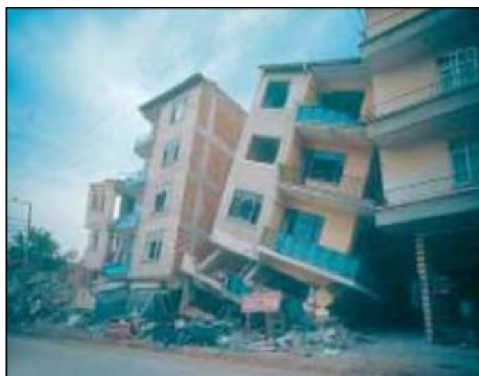
FIGURE 1.7 : Bâtiment d'habitation de 3 étages, (EL Asnam, Algérie), est endommagé par le séisme de 1980 d'EL Asnam
