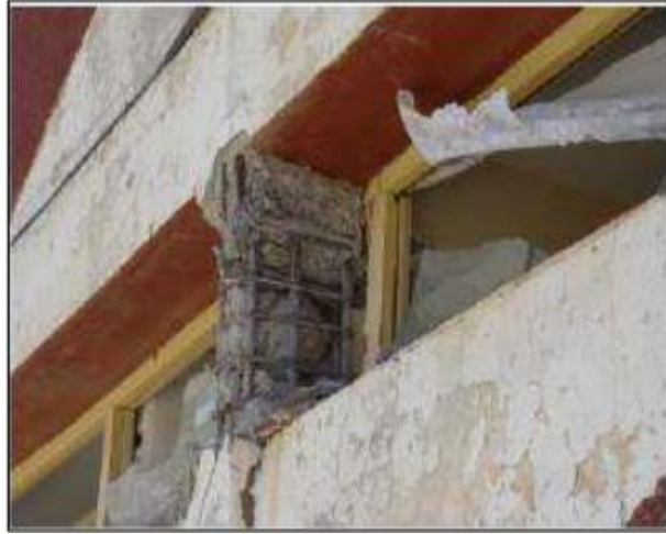
FIGURE 1.12 : Destruction des poteaux à cause du fonctionnement en "poteaux courts", séisme de 2003 Boumerdes
