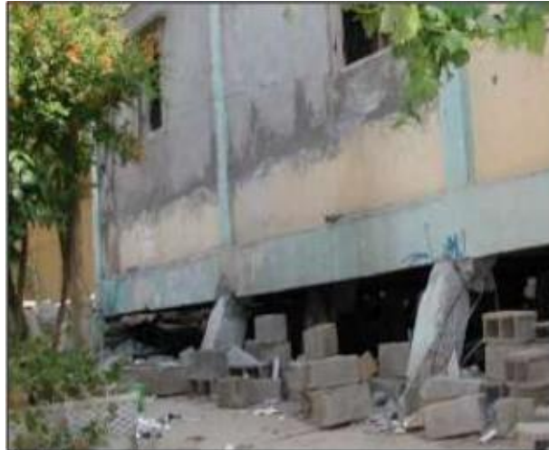
FIGURE 1.13 : Détail de destruction des poteaux à cause du fonctionnement en "poteaux courts"
