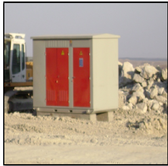
Figure (II.4.2) Poste sur SKID (Carrière EL KHEMAIES)
