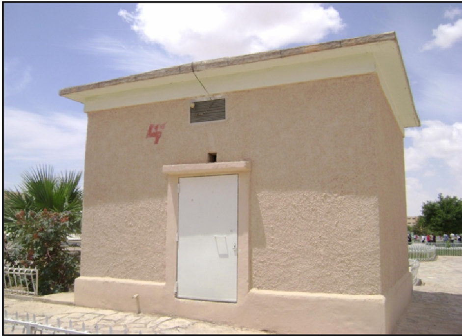
Figure (III.9) Poste maçonné (Université de M'SILA)
