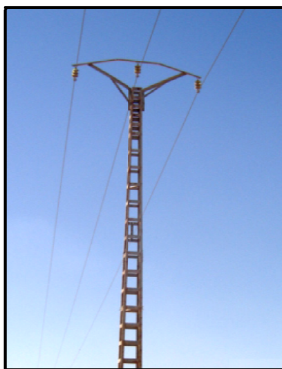
Figure (I.5) Pylône métallique MT
