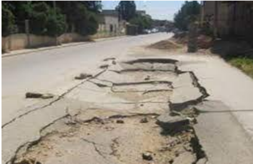
Figure I.9 : Fissures, tassements sur la route du Tlemcen.
