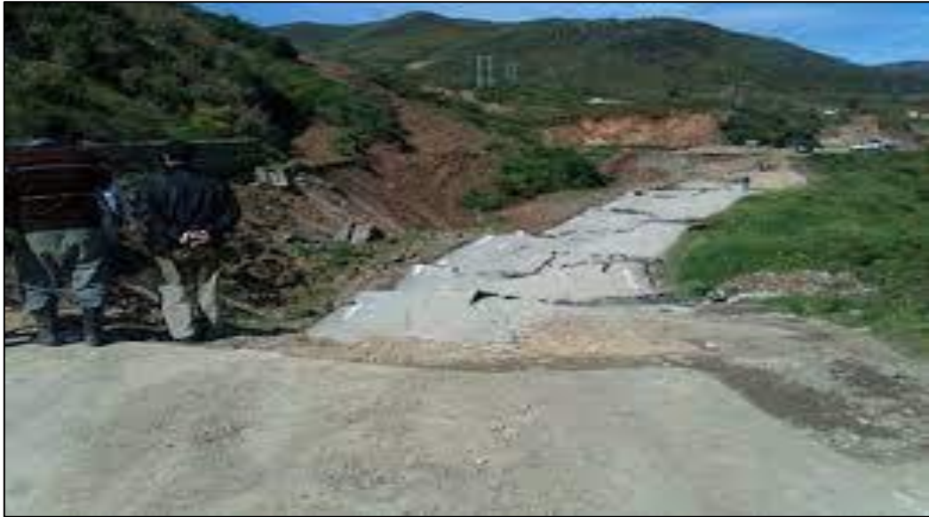
Figure I.12 : Affaissement de terrain à route national 24 (Alger).
