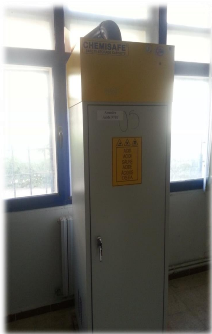
Figure 24 : Armoire de stockage des acides au magasin
