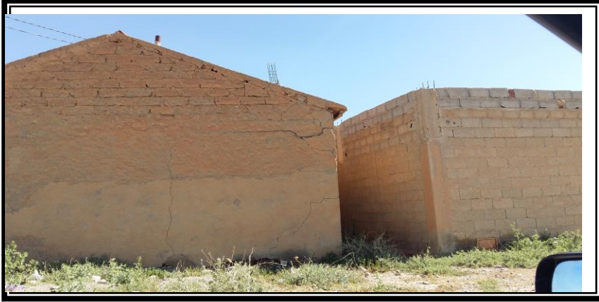
الصورة رقم : ( 12 ) سكن في حالة رديئة بحي بوخميسة
