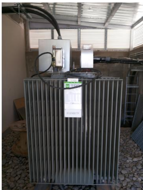
FigureIV-15 : Transformateur élévateur 690V/30kV
