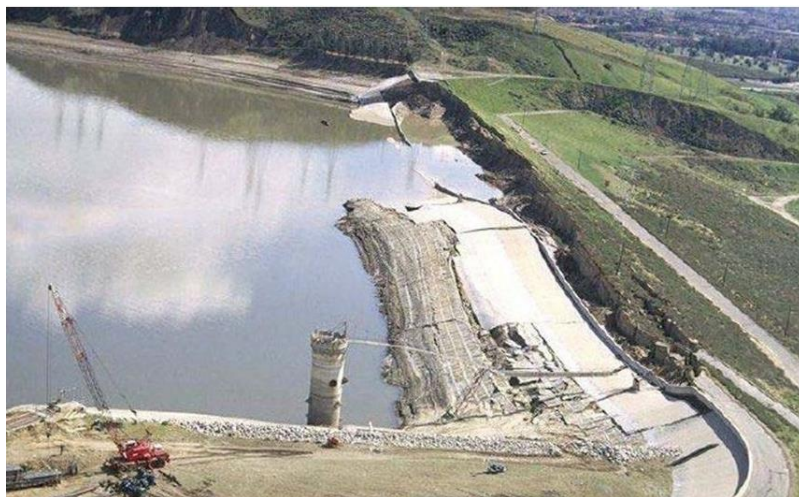
Fig. 1.12 Rupture par liquéfaction [9]
