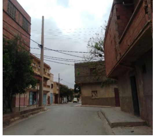
صورة رقم (14): خط كهرباء متوسط الشدة
