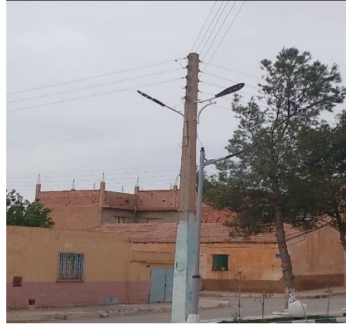
الصورة رقم (38): أعمدة الانارة
