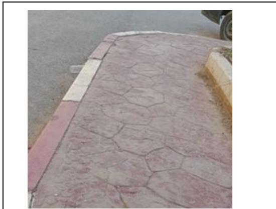
الصورة رقم 07: رصيف داخل حي 1600 مسكن عدل
