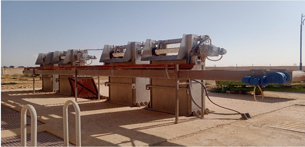
Figure III.03 : Les dégrillages grossiers.
