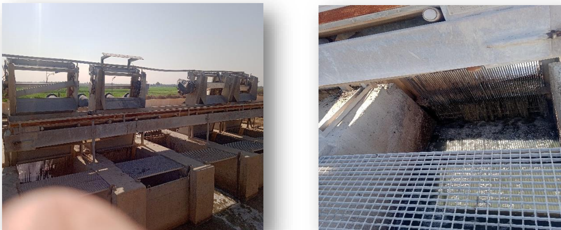
Figure III.05 : Les dégrilleurs fins.
