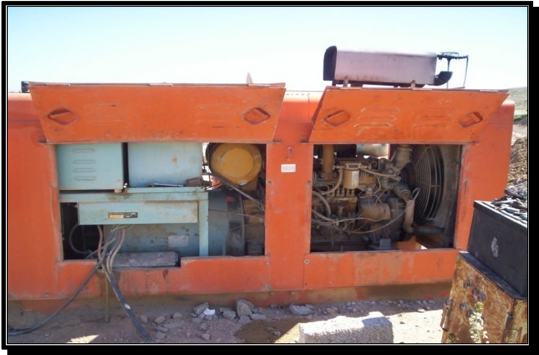
Fig. II.2 : Groupe électrogène entraîné par moteur diesel.
