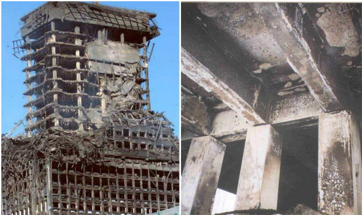
Figure 18 : À gauche, photo du bâtiment Windsor à Madrid après l’incendie. À droite, dessous du tablier du pont à Bruxelles après l’incendie [35] [37].
